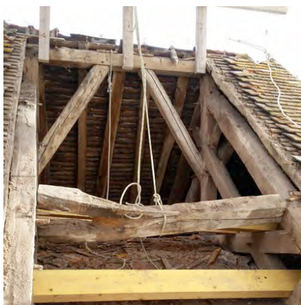
Église de Brenouille - Travaux de toiture Poutre cassée sous le poids.
